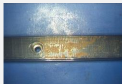
トラックレールに発生した例
